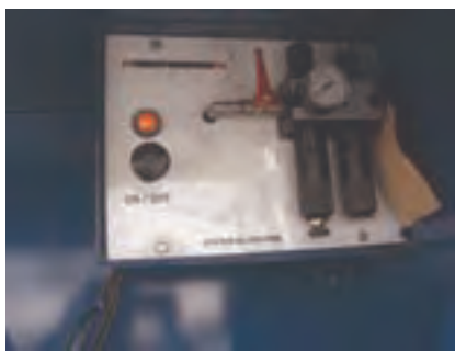
شکل ۴- تجهیزات اندازه‌گیری دما و فشار
